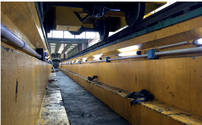
Illuminazione fosse ferroviarie
