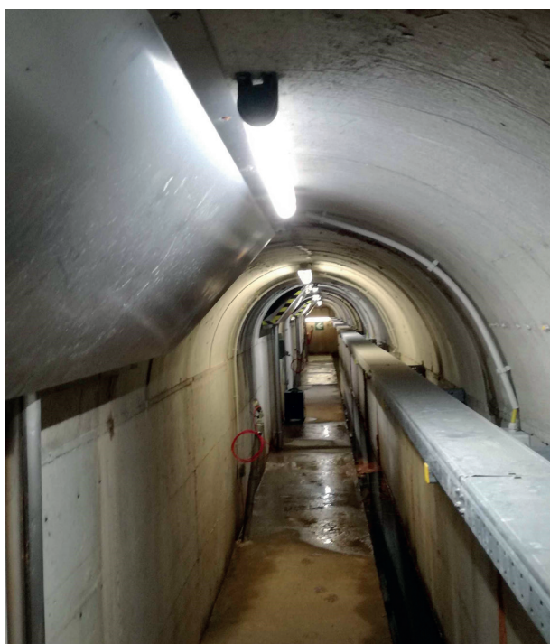
Illuminazione cunicoli e tunnel
