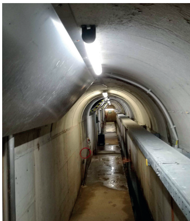
Illuminazione cunicoli e tunnel
