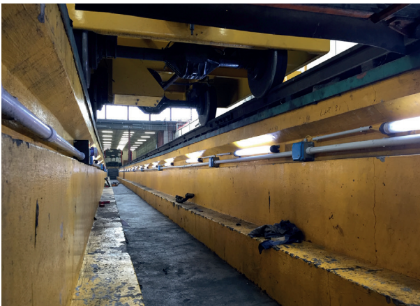
Illuminazione fosse ferroviarie
