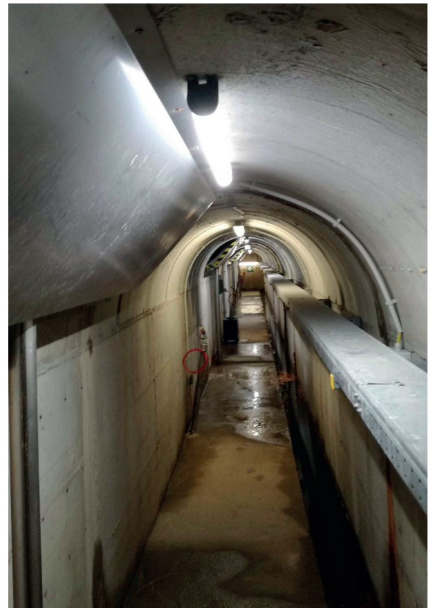
Illuminazione cunicoli e tunnel
