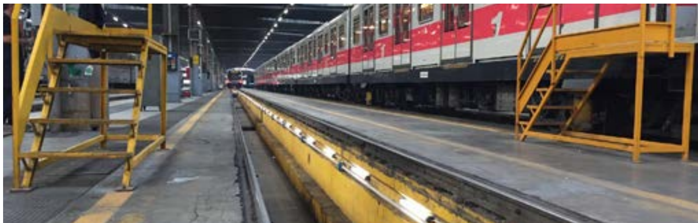
Illuminazione fosse ferroviarie
