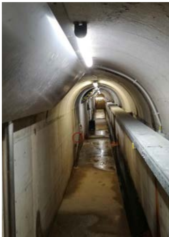
Illuminazione cunicoli e tunnel
