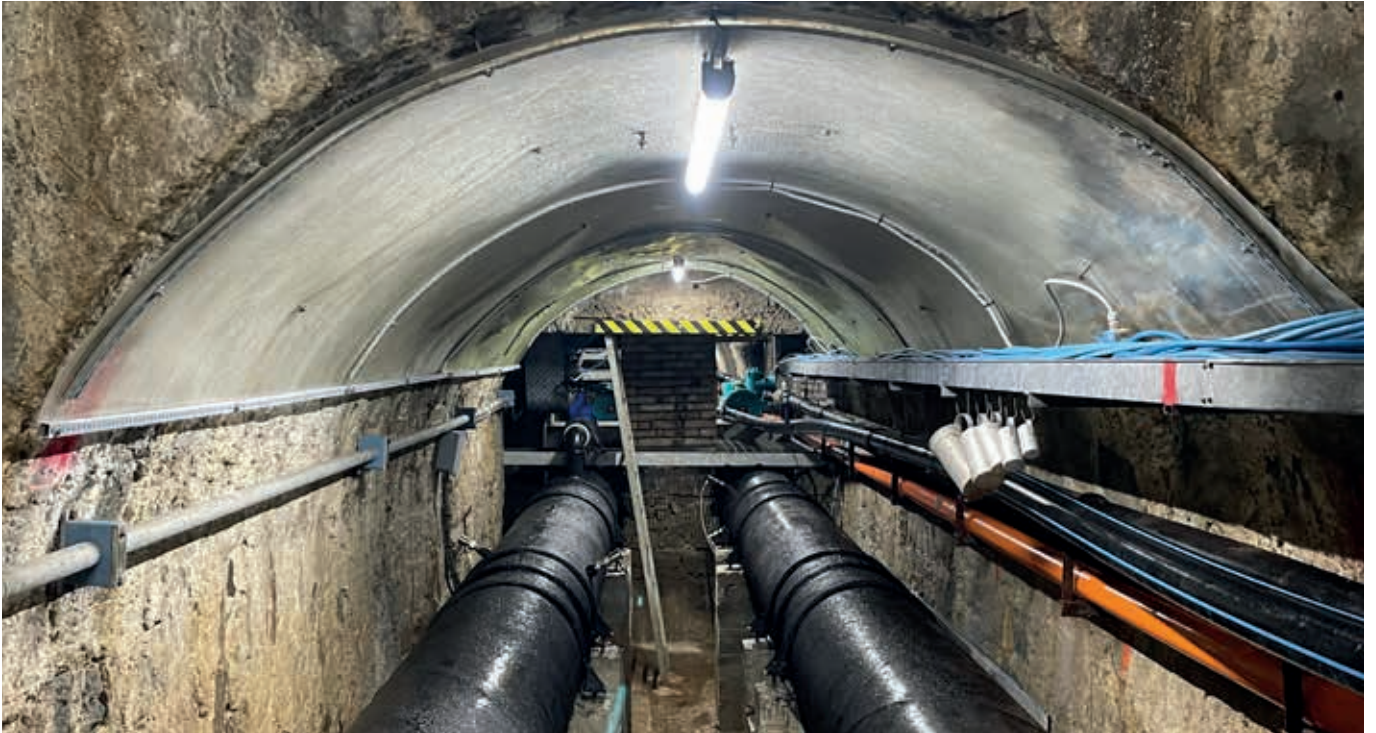
Illuminazione cunicoli e tunnel
