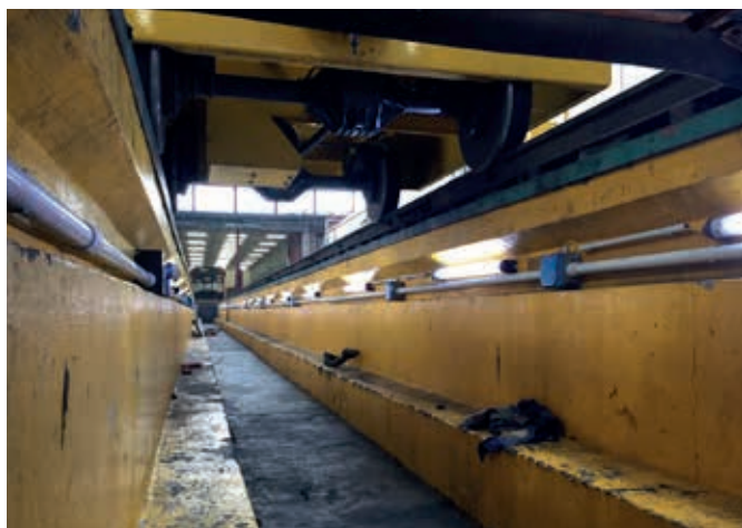
Illuminazione fosse ferroviarie
