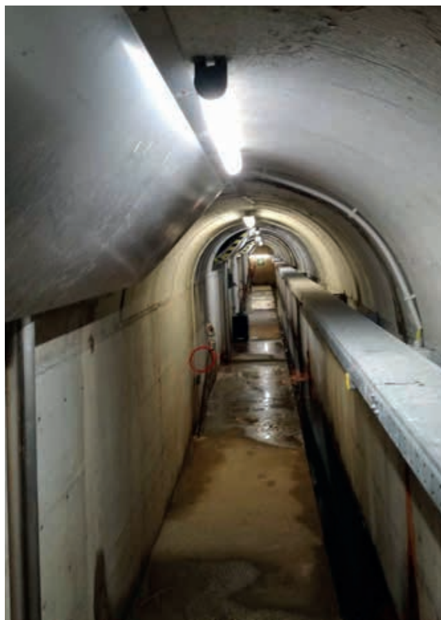
Illuminazione cunicoli e tunnel
