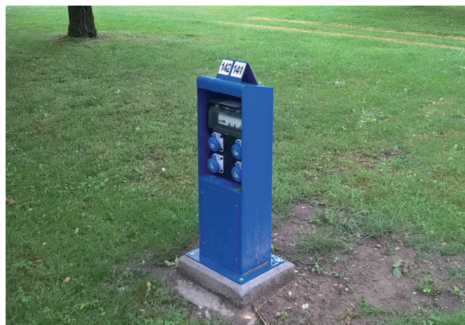
Quadro elettrico in gomma
