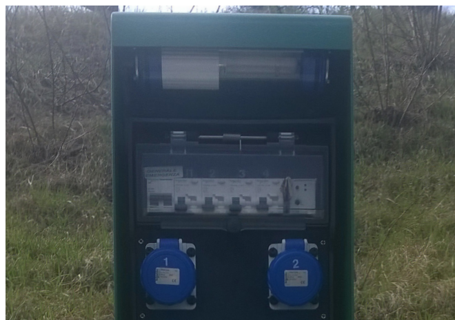
Quadro elettrico in gomma e lampada di cortesia
