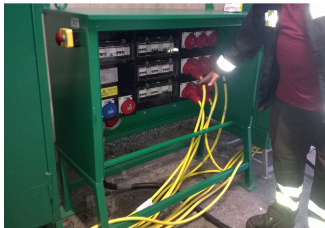
Quadro elettrico in gomma
