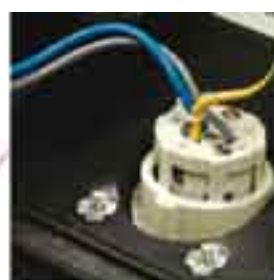
Cablaggi singoli tra interruttori e prese.
